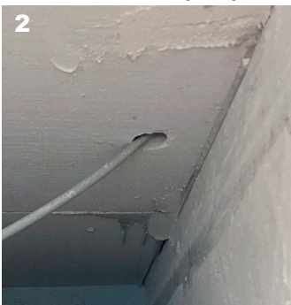
2 For stort et hul omkring ledningshullet, skulle have været fuget / Too much space around the wiring, must be grouted.
